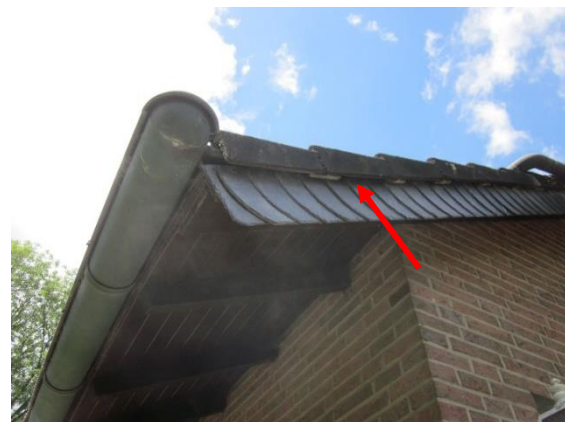
Abb. 7: Hohlräume zwischen Dachziegeln und Schieferplatten (ISR 2024).
